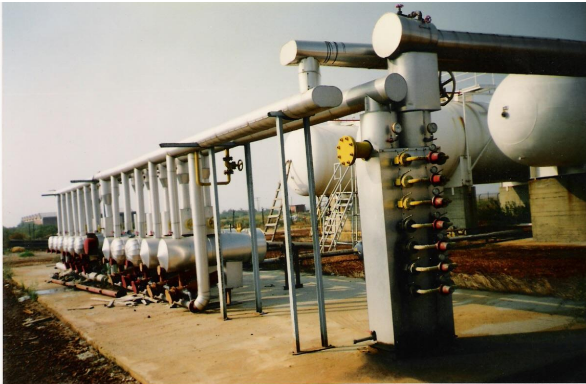
Εγκατάσταση υγραερίου εργοστασίου βάρβακος
