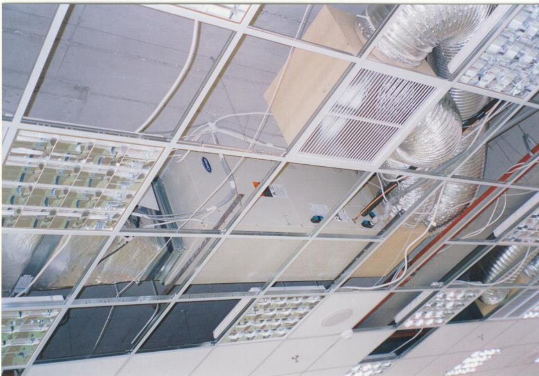
Εγκατάσταση κλιματισμού S/M ΜΑΣΟΥΤΗ
